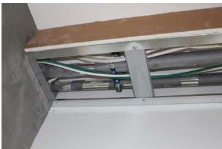
Kaapelireitit kulkevat putkilynjojen kanssa rinnan
