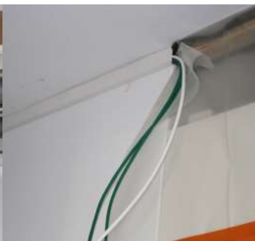
Huoneistossa kotelossa kulkevat kaapelit
